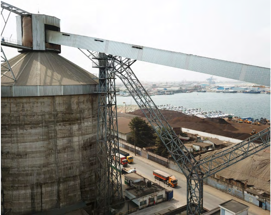
Photo du Silo Clinker
